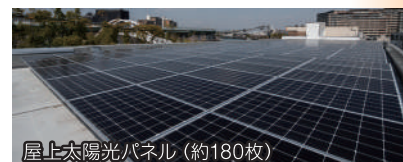
屋上太陽光パネル（約180枚）
