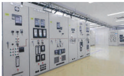
受変電実習室
